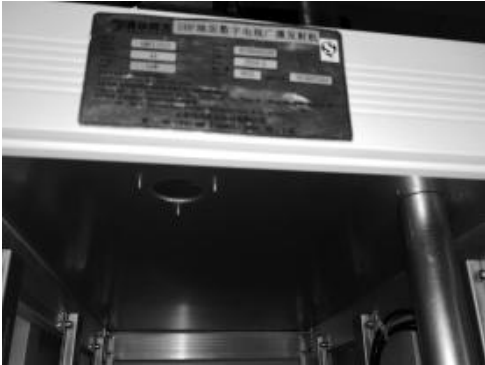
图二 数字电视发射机机柜顶部
